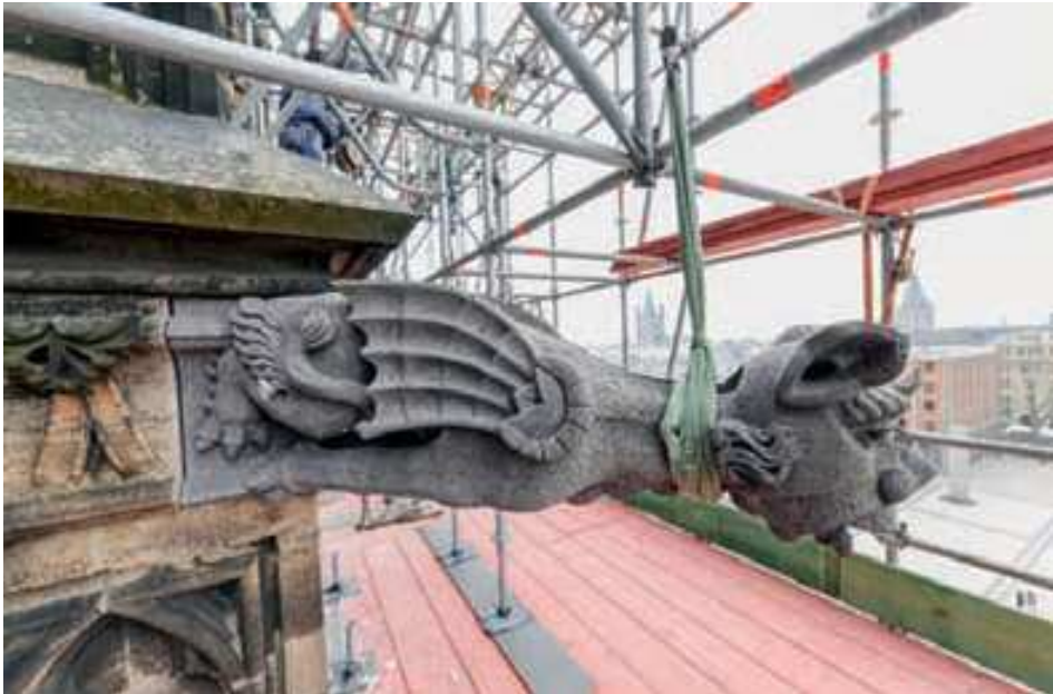
7. Der versetzte Wasserspeier an der Westecke von Pfeiler G 8.
