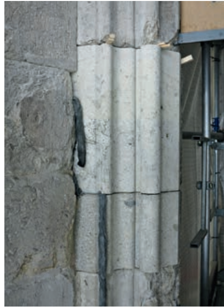
13. Aus Drachenfels-Trachyt erneuertes Werkstück im Gewände des Fensters F 15–F 15.1
