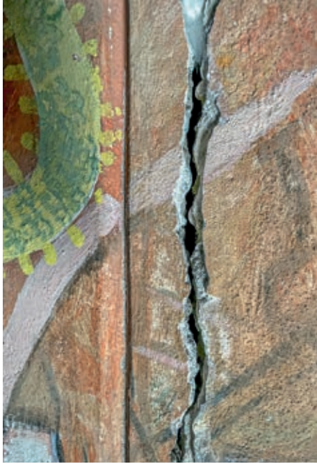
20. Materialausbrüche an den Kanten eines Risses, der mehrere Bildmotive der Malereien unter der Orgelempore durchzog
